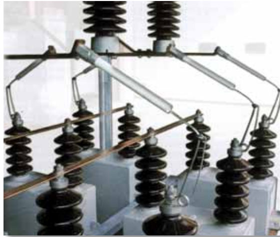
View of capacitors with expulsion fuses. Vue des condensateur avec fusibles à expulsion.
