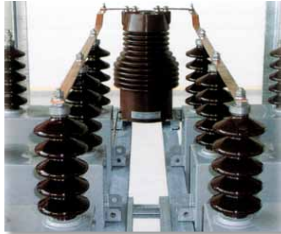
View of current transformer between two star centres of a bank of capacitors. Vue du transformateur de courant entre deux centres étoile d'une batterie de condensateurs.
